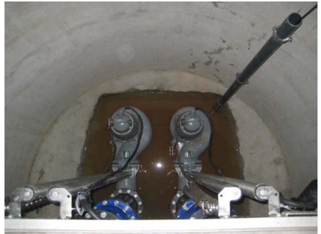
Pumpwerk zur Rückstausicherung Q=120\text{ l/s}
