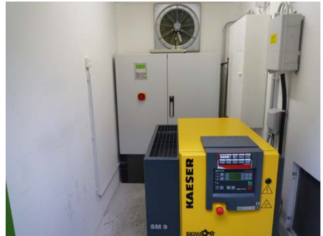
Kompressoranlage mit Steuerung
