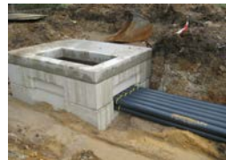
Kabelschacht und Kabeltrassen
